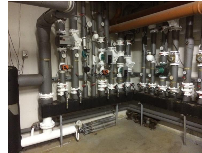
Armatury a potrubí
