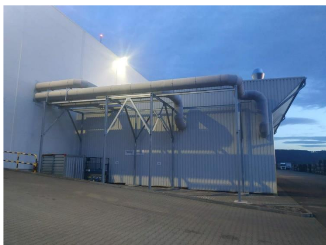
Klimatizační systémy - potrubí
