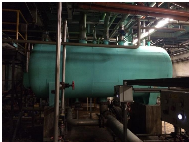
Nádrž na vodu
