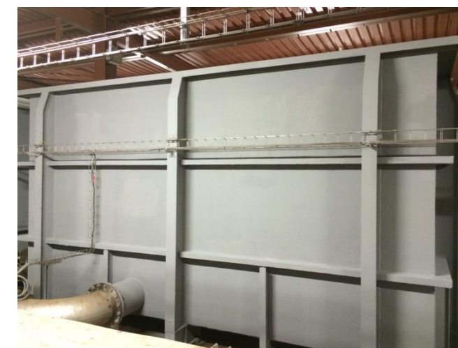
Nádrž na vodu
