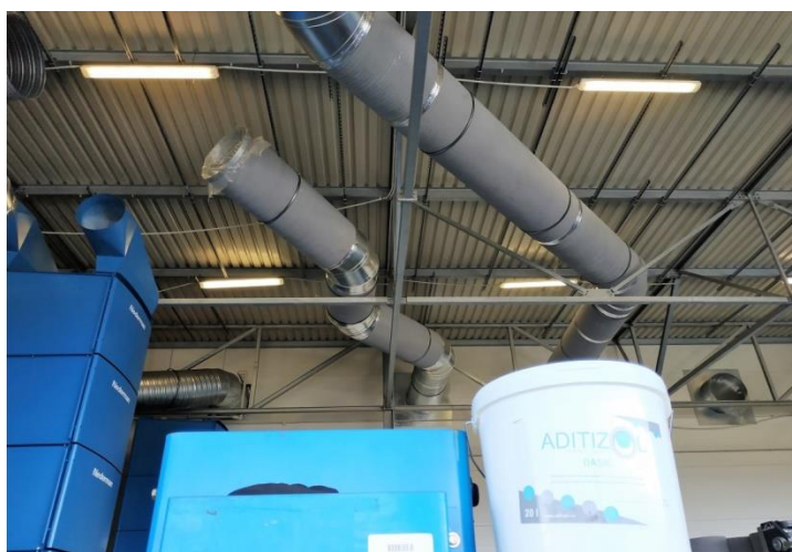
Klimatizační systémy - potrubí
